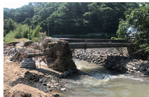
奈良ノ木橋の崩壊（高屋町）
