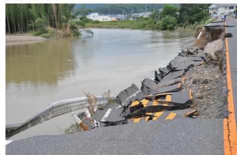
国道486号の崩壊（西江原町）
