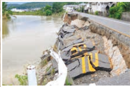
▲ 18 平成30年7月豪雨により西江原町地内の国道486号が崩落
