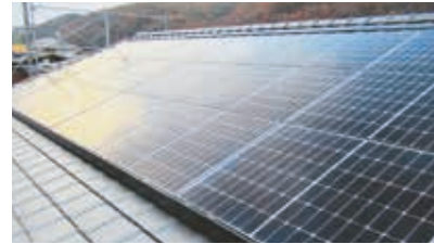
住宅用太陽光発電システム等設置費補助金
