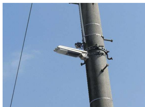
☆光害対策型LED防犯灯
