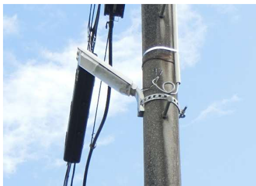
☆通常のLED防犯灯
