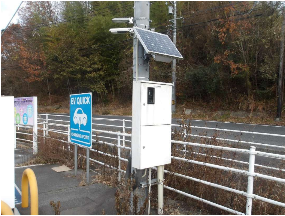
現場写真②（街灯及び街灯発電用ソーラーパネル）
