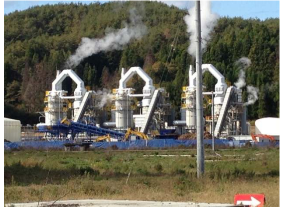
瓦礫処理のプラント
